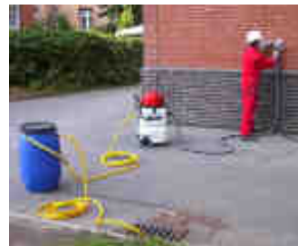
Abwassersystem mit Wandreinigungshaube, Wasserpumpsauger, Filteranlage
