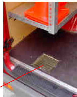
Entlüftung im Boden des Arbeitsmittelraumes
